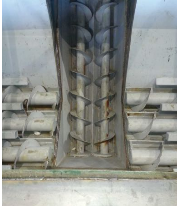
Figura 5: dettaglio delle coclee estrattrici poste all'interno della vasca di scarico dei SOA in ingresso all'impianto.
