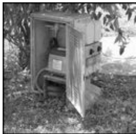
ESEMPIO DI LOCALE TECNICO
