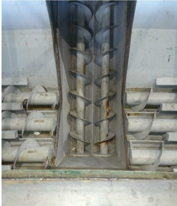
Figura 5: dettaglio delle coclee estrattrici poste all'interno della vasca di scarico dei SOA in ingresso all'impianto.
