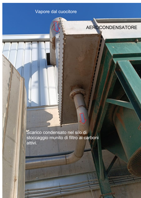
Figura n. 13 – dettaglio delle connessioni dell'aerocondensatore
