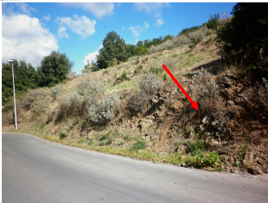
Fig. 29 – Superficie alterata e lieve dissesto in trincea parte bassa di Via La Malfa (Condizione estate 2013)
